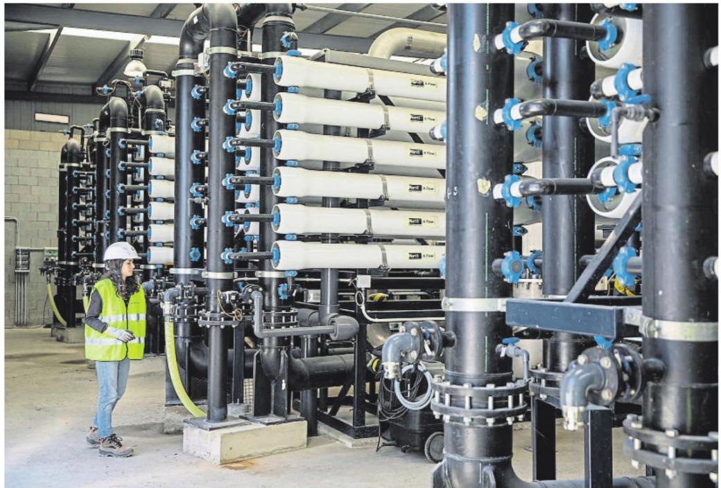
Planta potabilizadora de aguas subterráneas de Besòs en el barrio de Trinitat de Barcelona
